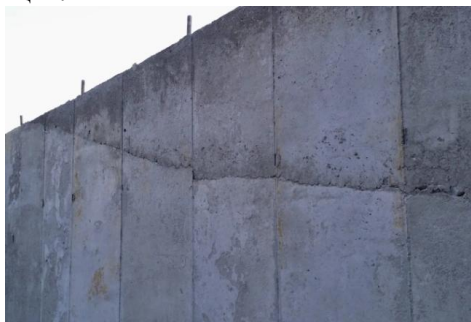
Рис. 1. Непроектный рабочий шов бетонирования при перерывах в бетонировании
