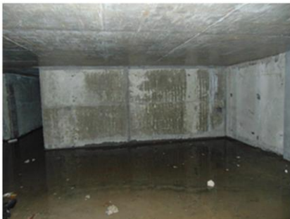
Рис. 1. Повреждения подвального помещения объекта
