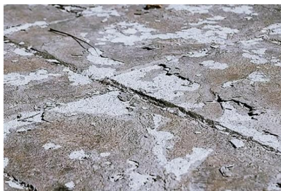
Рис. 1. Дефекты бетона после замораживании бетонной смеси на раннем этапе бетонирования
